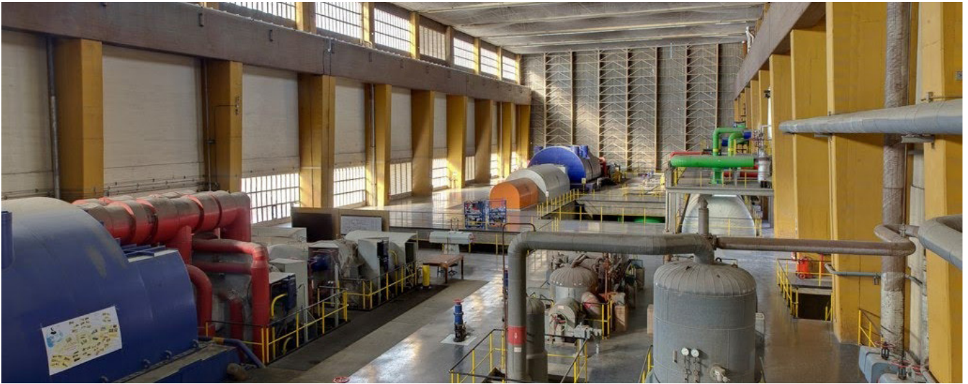
Interior de la nau de turbines just abans del seu desmantellament.
